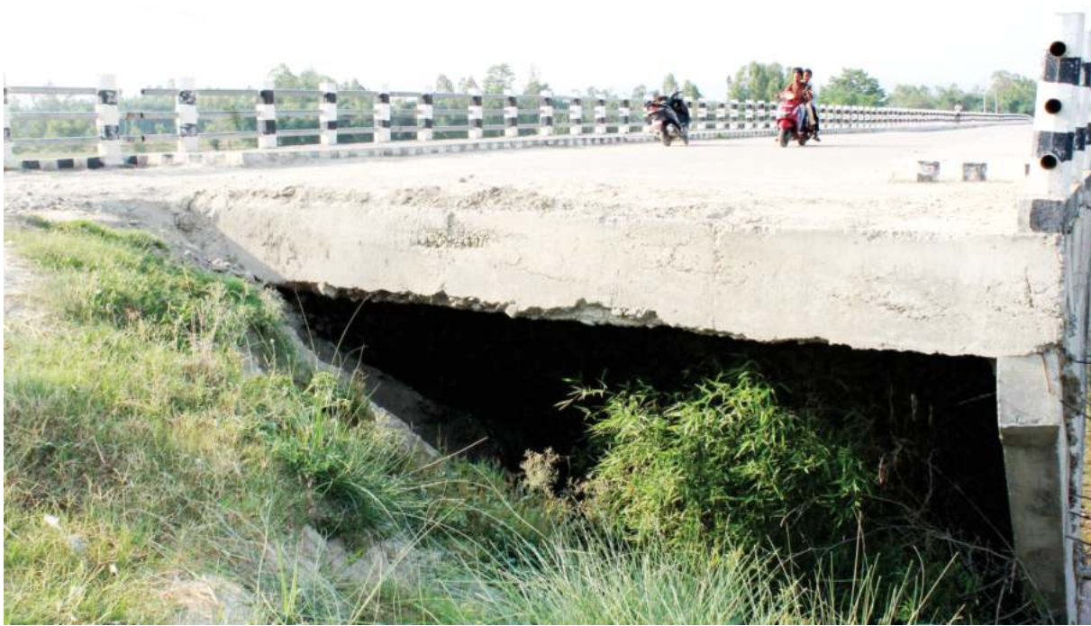
जीर्ण पुल: सर्लाहीको लालबन्दी नगरपालिका-३ जब्दी र ईश्वरपुर नगरपालिका-८ रामपुरलाई जोड्ने फूलजोर खोलाको जीर्ण पुल । यो पुलको दुवैतर्फ ठूलो खाल्डो परेर जीर्ण बनेको लामो समय भइसकदासमेत मर्मत हुन नसक्दा दुर्घटनाको जोखिम बढेको छ । तस्बिर:विश्वनाथ ठाकुर
