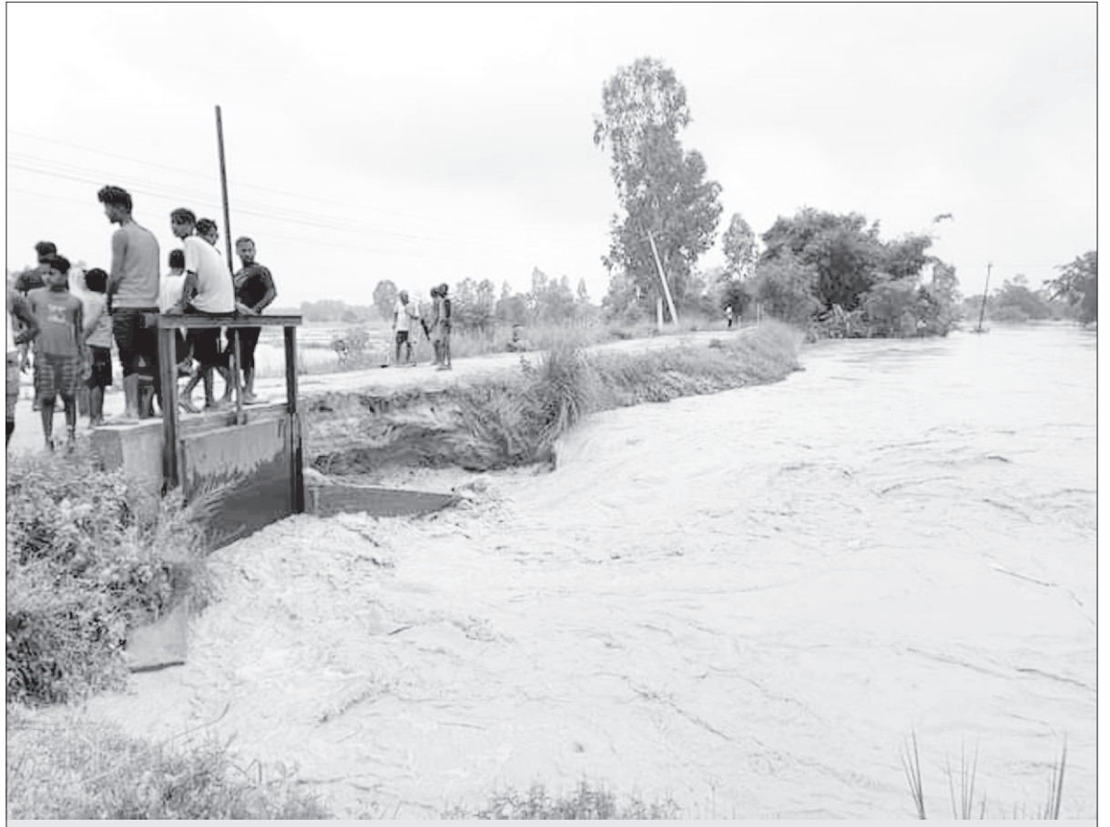
बाढीले सडक भत्काउँदै: महोत्तरीको रातो नदीमा आएको बाढीले बलवा नगरपालिका-१ स्थित नहरको फाँट नजिकै सडक भत्काउँदै । तस्बिर: सञ्जीतकुमार मण्डल
